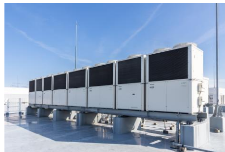
設置されているパナソニック製 ガスヒートポンプエアコン
