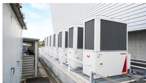
設置されているヤンマーエネルギーシステム製 ガスヒートポンプエアコン
