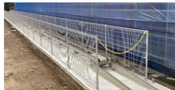
緑化台車自動運搬設備
