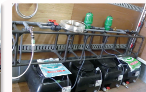
【灌水制御装置】
