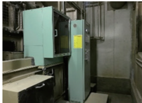
バーナー調節盤・監視盤設置例
