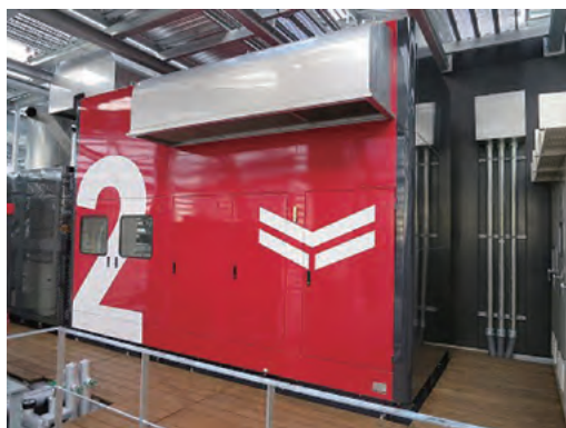
ガスコージェネレーションシステム (FLYING-Y BUILDINGのみの特別塗装)
